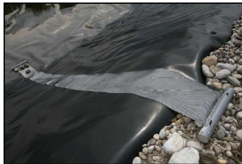
Figure 13 : Echappatoire installé sur un bassin
